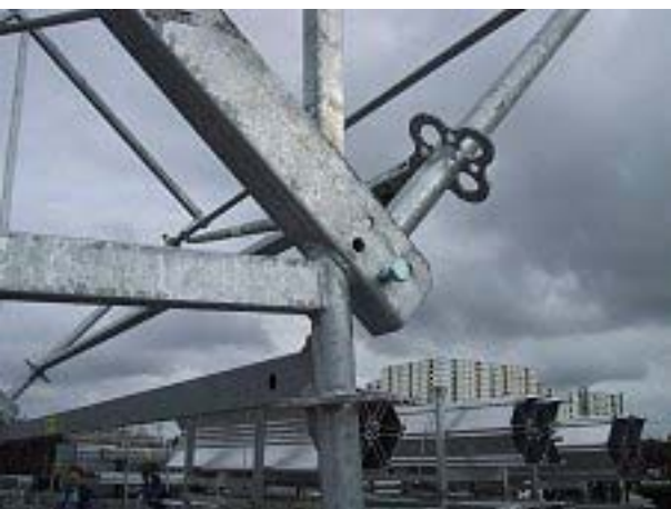
Der monteres 2 M 16x90 bolte i både top og bund af endevederlaget.
